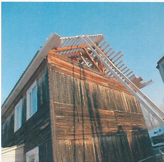
Ремонт крыши в многоквартирном доме по адресу: г. Колпашево, ул. Кирова, д. 40
